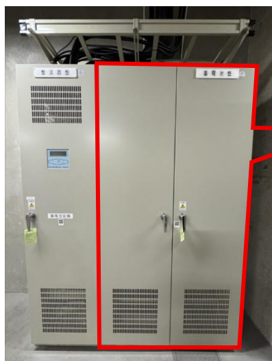
直流電源装置
